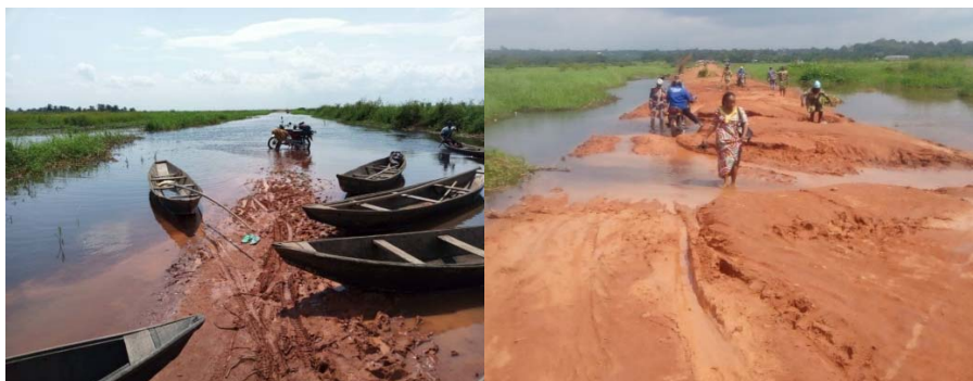
Planche 3: voie inondée et dégradée à Tovè (Arrondissement de Kessounou) Prise de vue : Babadjidé, 2019
